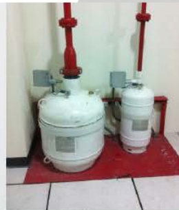
ระบบดับเพลิง
